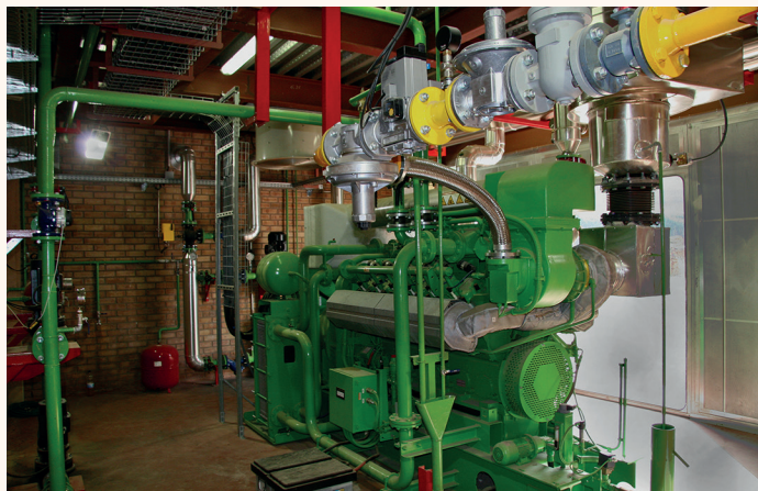
Figura 3. Sistema de cogeneración de energía eléctrica.
