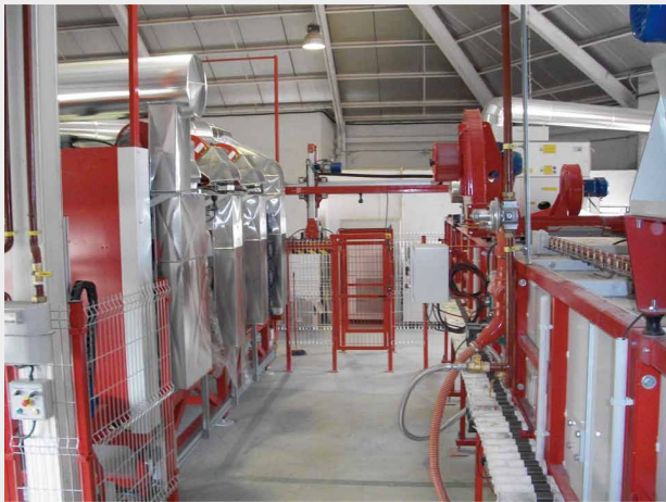
Foto 1 Vista general de la instalación
